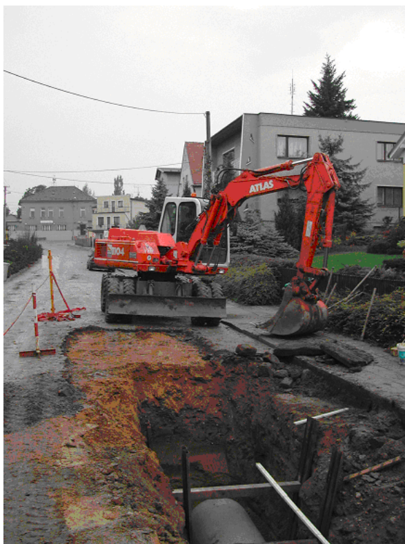
Obr. 8 - Výkop bez pažení, výkopy provedené bez zásad pažení, které nebyly stanoveny v projektu
