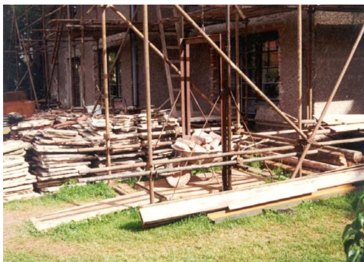
Obr. 10 - Výtah - tzv. „plošinka na jedno kolečko“ – neprovedeno úhlopříčné ztužení konstrukce výtahové věže, neprovedeno ohrazení konstrukce výtahové věže, výtahová plošina není ohrazena do výše 1,1 m, není vyznačena nosnost a zákaz jízdy osob
