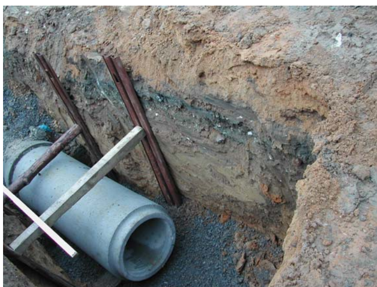
Obr. 9 - Nezapažený výkop, do kterého vstupují pracovníci
