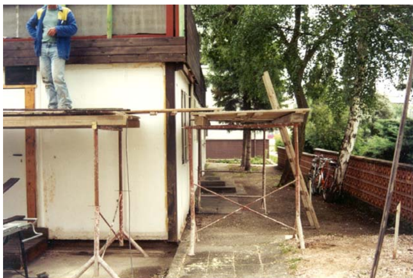
Obr. 3 - Kozové lešení bez úhlopříčného ztužení a bez vybavení bezpečnostními prvky (chybějící zábradlí, zarážka u podlahy, žebřík nezajištěn proti podklouznutí, sesmeknutí)
