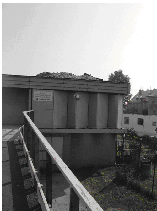
Obr. 1 - Nezajištěné pracoviště při práci ve výšce
