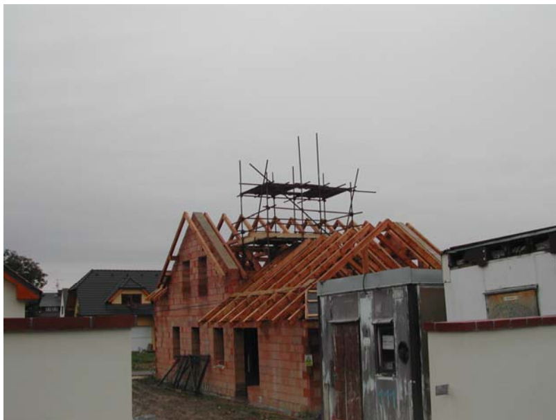
Obr. 2 – Nedostatečně vybavené prostorové lešení
